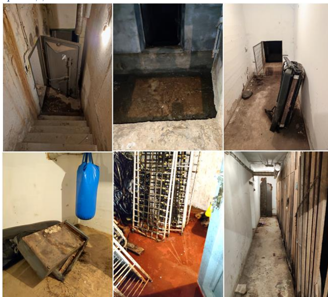
Слика 13. Трагови плављења, присуство воде, оштећена опрема и отпад у склоништу, Матице српске 64, Београд, 2023. година, фото ДРИ
